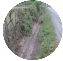
Un entretien excessif : le fossé a été trop profondément curé et raboté ; la haie, déchiquetée.
